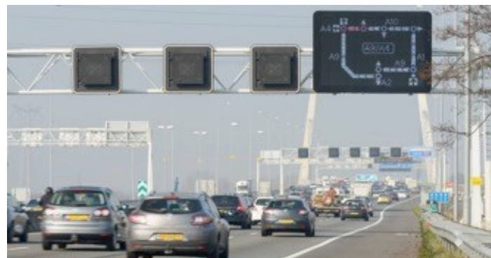
Inzet bestaande DRIP's (Dynamische Route Informatie Panelen) en extra dynamische displays
