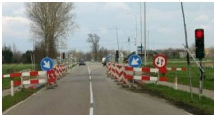
Tijdelijke verkeerslichten en/of doseerinstallaties
