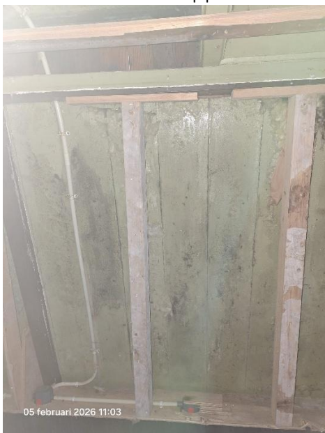
Foto van zwarte schimmel op de muren
