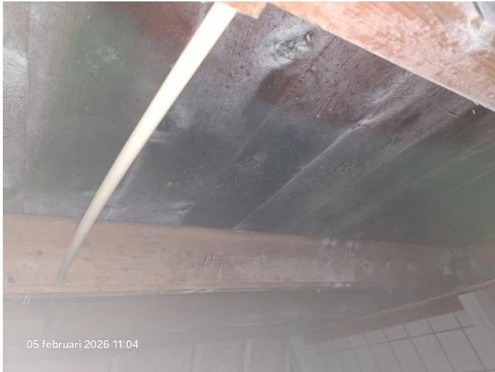
Foto van schimmel op het plafond
