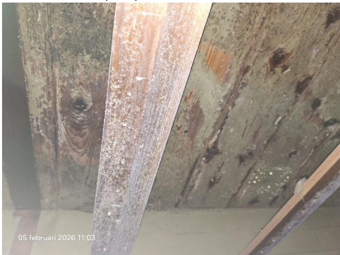
Foto van zwarte schimmel op plafond
